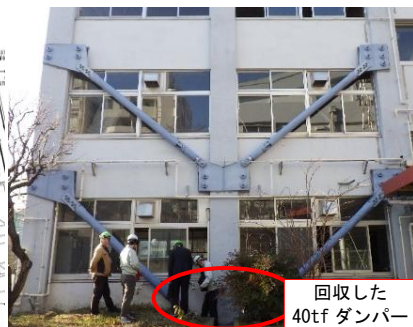
写真 2 回収前の設置状況
