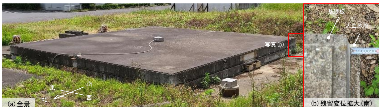
写真4 実大滑り基礎の暴露状況（10年後）
