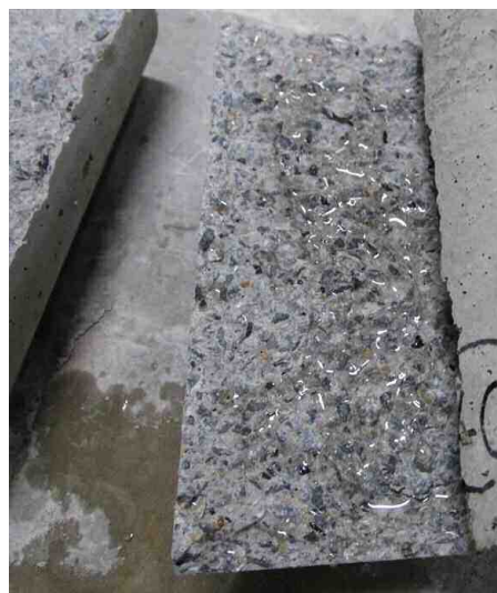
写真2 内部の水滴の状態
