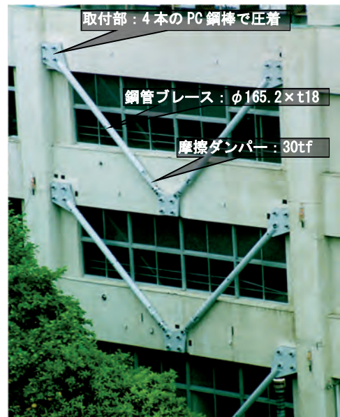
写真1 制震ブレースの取付例
