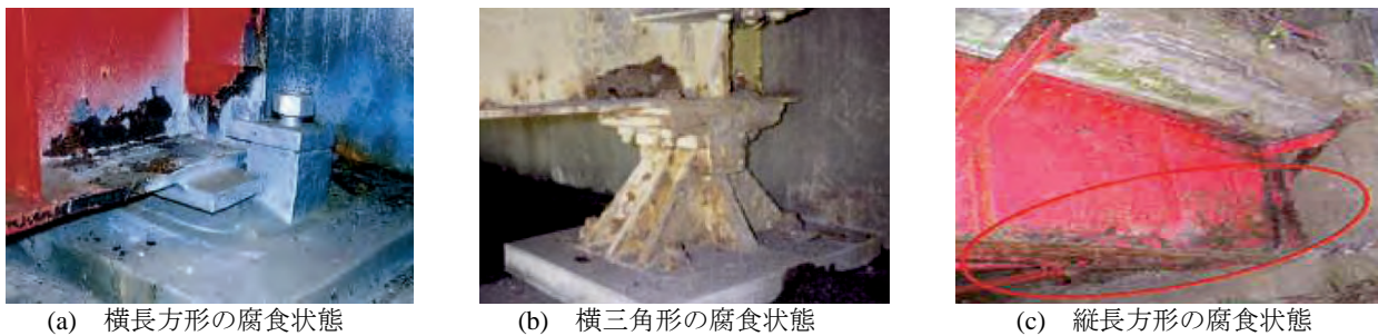
図 1 既設鋼橋の端部パネルにおける腐食事例
