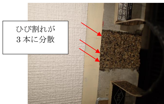
写真1 ひび割れ分散性の確認実験
