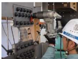
a) LD12-6 の設置状況
