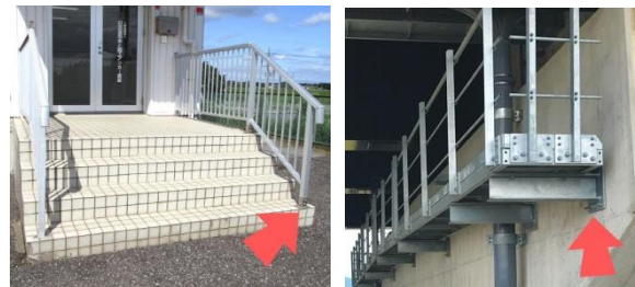
(a) 手すりの固定 (b) 検査路の固定 写真1 あと施工アンカーの施工事例 1)
