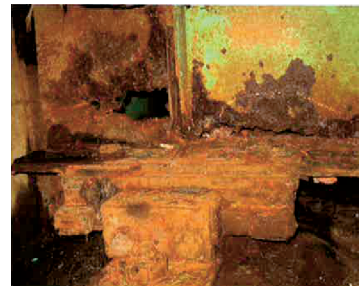
写真 1 港湾鋼構造物の端部局部腐食の事例 5)
