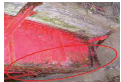
(c) 縦長方形の腐食状態 5)
