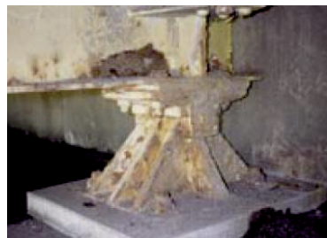
(b) 横三角形の腐食状態 1)
