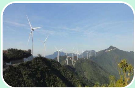
Kunimiyama Wind Farm
